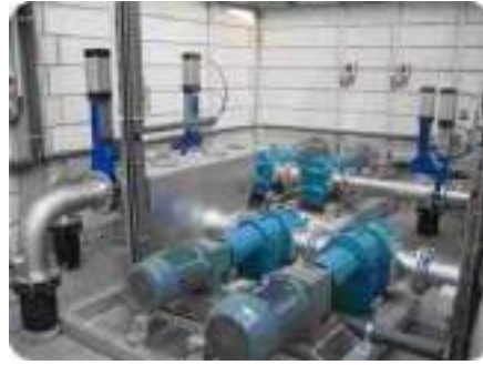
Рисунок 4. Насосна станція для перекачування гною
